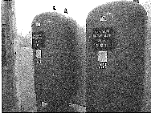
加壓氣鼓鼓膽漏氣
