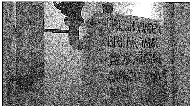
樓層減壓缸房沒有通道進入維修保養
